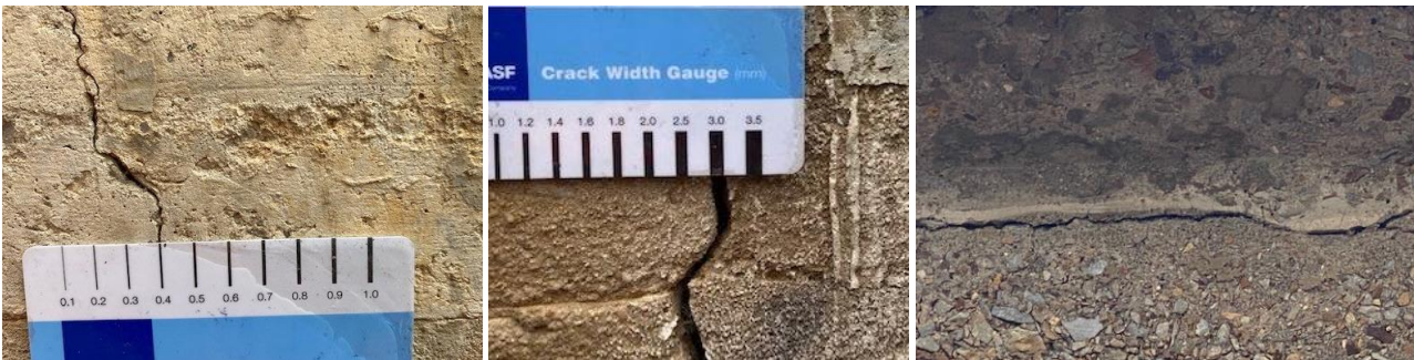
(d) Wingwall small cracking
